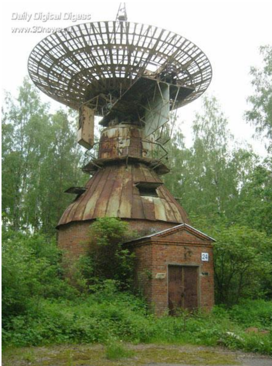
Еще один аналогичный страдалец. Из новинок последнего времени - свежая нащелка с номером дома и никакой реставрации или сноса. Упадет ведь.
