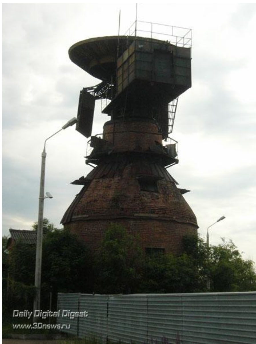
Первая спутниковая станция СССР. Короб сверху набит старой и ранее сверхсекретной радиоаппаратурой. Еще лет двадцать назад это был ведомственный объект с вооруженной охраной. Сейчас, того и гляди, обвалится.
